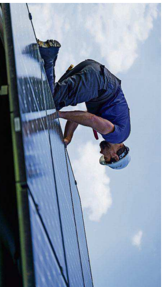
Für Reihenhäuser im Land Bremen gibt es gute Nachrichten: Photovoltaikanlagen dürfen künftig mit weniger Abstand auf dem Dach installiert werden. Foto: Cloudbox
