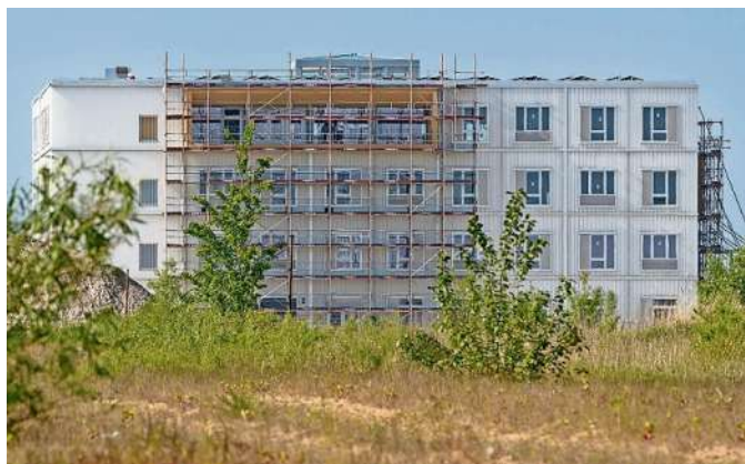
Auf rund 6.500 Quadratmetern entstehen im Luniq Büros, Werkstätten, Co-Working-Bereiche und Begegnungsflächen für junge Unternehmen der „Green Economy“.
